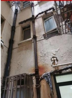
管道歪斜/风化/生锈/破损
